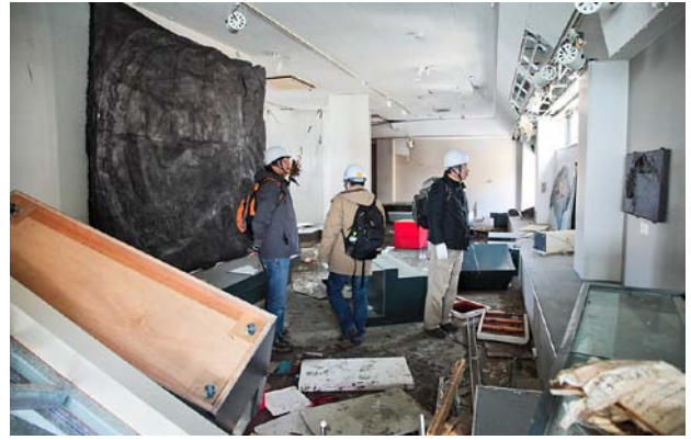
図5. 南三陸町歌津魚竜館（水産振興センター）2階展示室被害状況（2011年4月4日撮影）。
