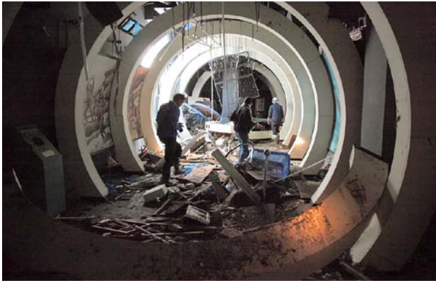
図10. 石巻市おしかホエールランド1階展示室導入付近被害状況 (2011年4月28日撮影)
