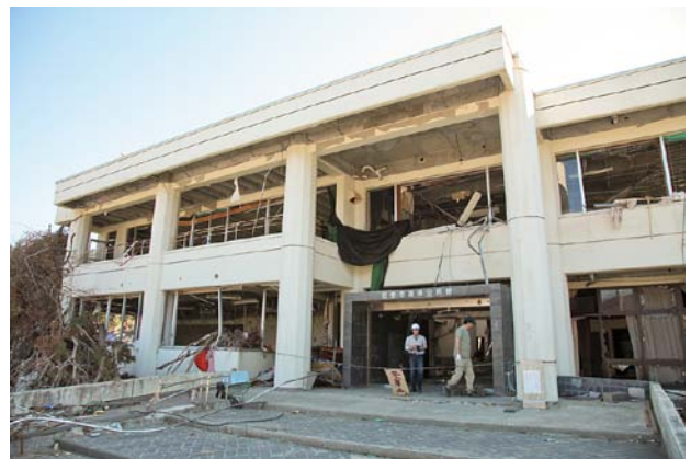
図6. 石巻市雄勝公民館正面被害状況（2011年5月18日撮影）。
