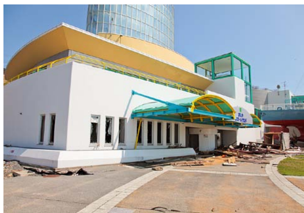
図9. 石巻市おしかホエールランド建物正面被害状況（2011年4月28日撮影）。
